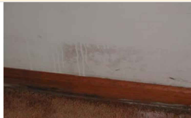
Moisissures sur cloison après infiltration d'eau prolongée. Photo Wikimedia Commons.
